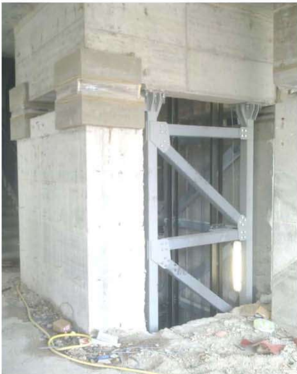
Figura 22. Viste dei dispositivi installati. © Kaltha s.r.l.
