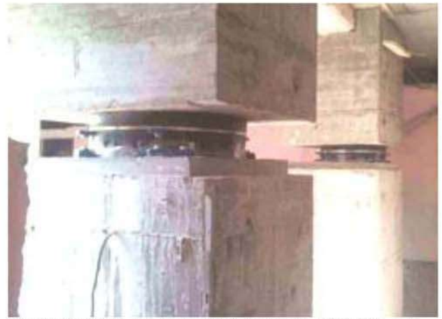
Figura 23. Viste dei dispositivi installati. © Kaltha s.r.l.
