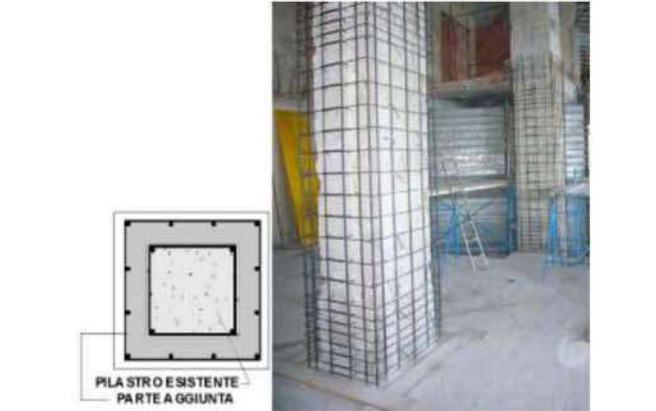
Figura 14 b. Intervento di adeguamento dei pilastri piano cantinato: documentazione fotografica. © Kaltha s.r.l.
