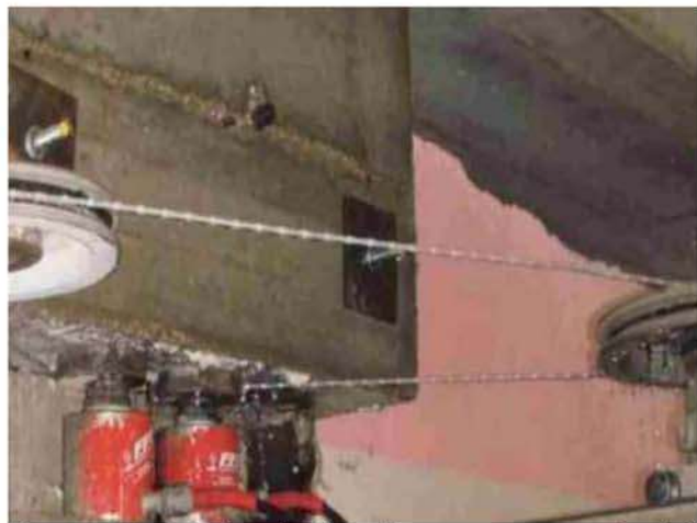
Figura 16. Martinetti di sollevamento e avvio delle operazioni di taglio dei pilastri. © Kaltha s.r.l.
