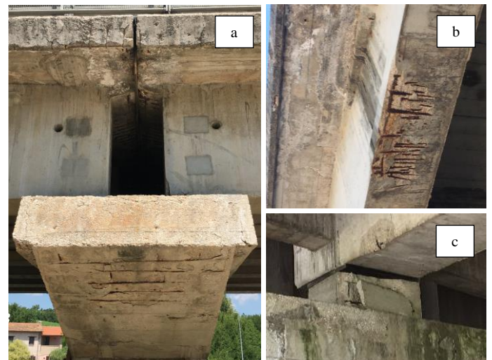
Figure 10. Degradation of a) joints and pier caps, b) beams and slab and c) supports / Stato di degrado di a) giunti e pulvini, b) travi e soletta e c) baggioli.
